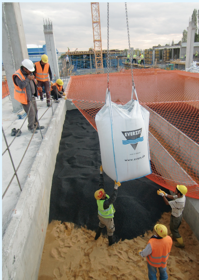
Bild 4 Filterbefüllung mit Everzit N im Wasserwerk Ankara
